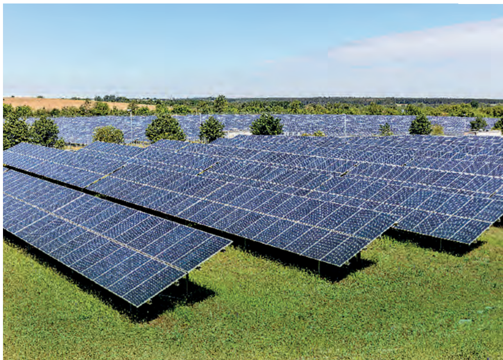
Un esempio di installazione di pannelli fotovoltaici
